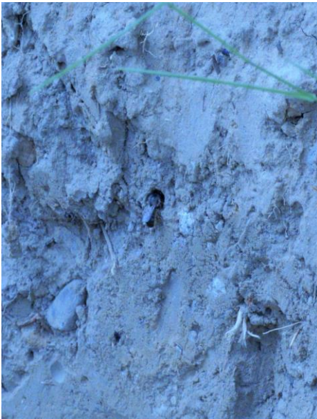
Abbruchkante ( Sand und Lehm)
